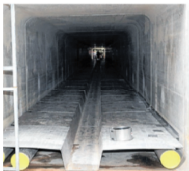
Das Herzstück: die Wärmetauscher, eingebaut im Kanal.
