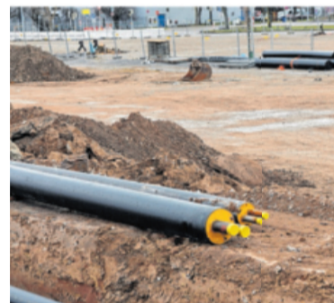
Die Rohrleitungen zum Verteilen der Heizwärme.
