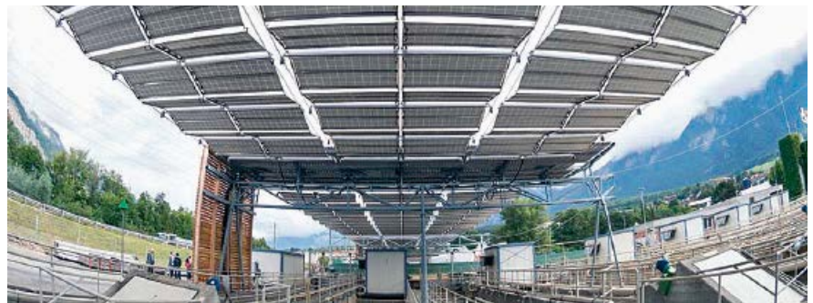
Solarfaltdach Horizon auf der Abwasserreinigungsanlage in Chur, Schweiz
